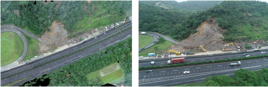
圖 1 國道 1 號南向 10.1k 邊坡第一次坍滑(111.11.02 拍攝)
